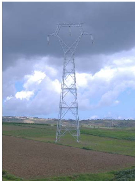
Figure 3 : Pylône du type « Chat » de la ligne HT Sidi Daoud-Menzel Temime
