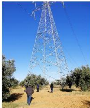
Pylône près de (S52)
