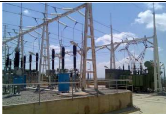
Figure 75 : Poste de Menzel Témine
