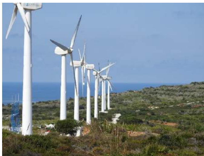
Les six éoliennes E9 à E16 (de droite à gauche)
