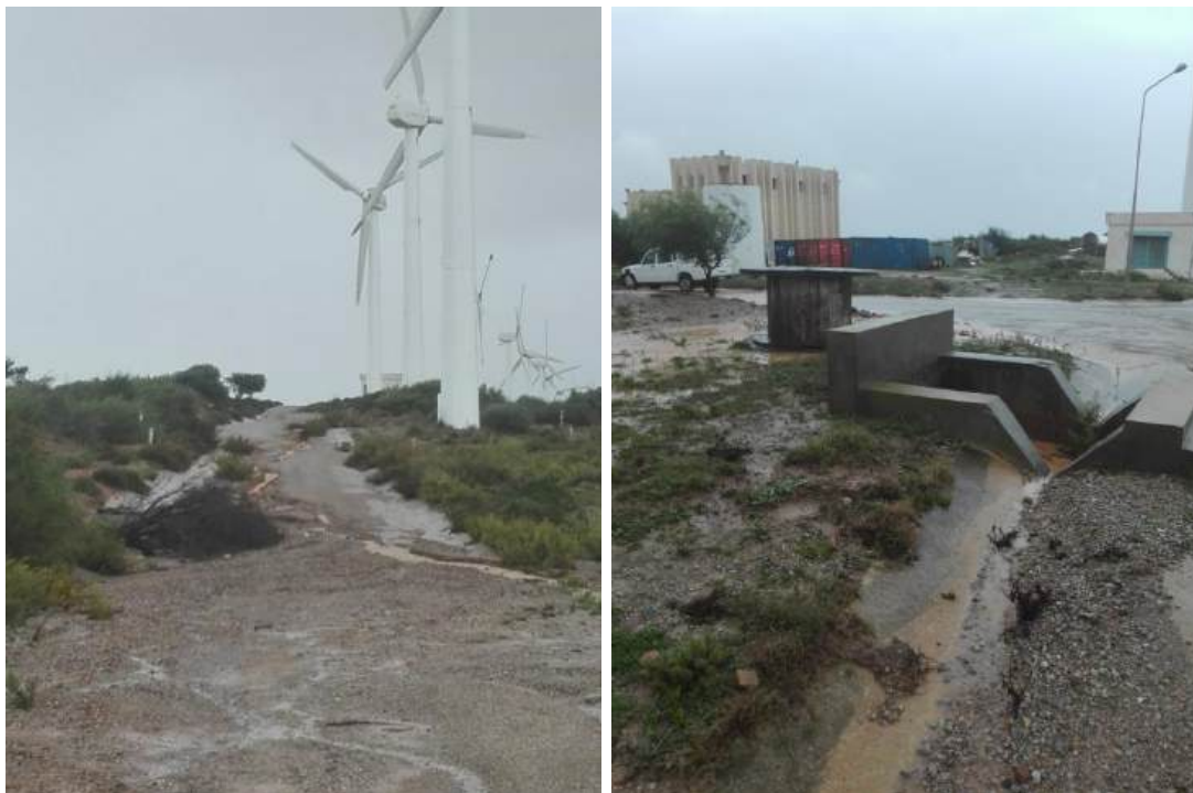
Figure 13 : État d'une partie du sol et du réseau de drainage
