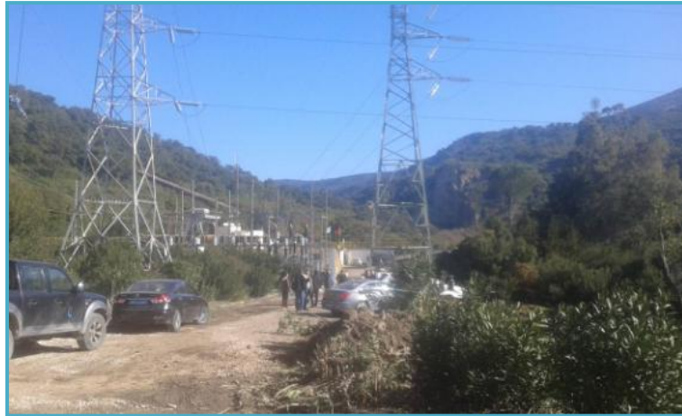
Figure 143 : Poste de Fernana.
