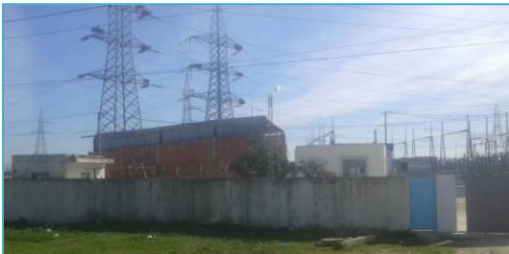
Figure 157 : Nids de Cigognes aux pylônes à Le poste de Jendouba.
