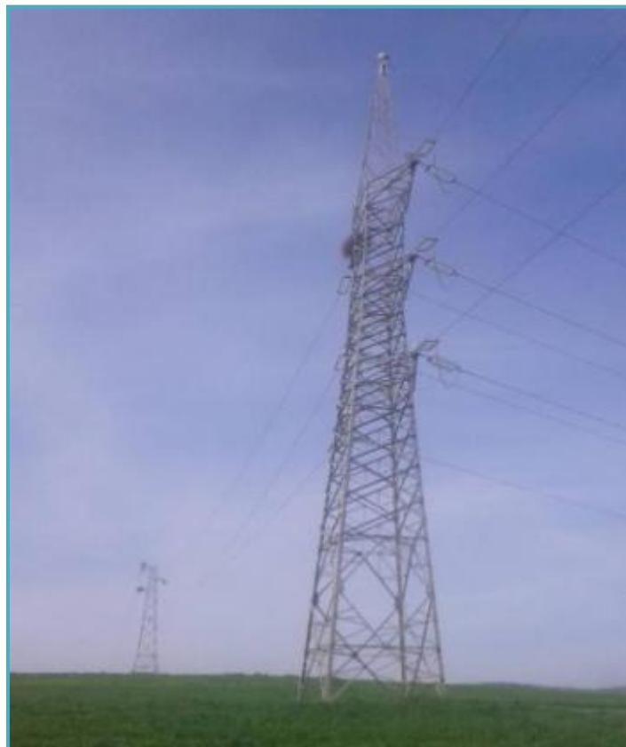
Figure 138 : Nid de cigogne au pylône proche au poste de Béja.
