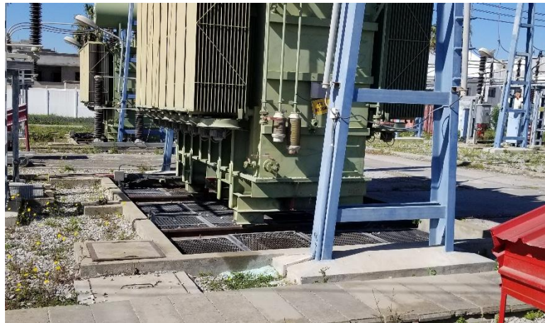
Figure 159 : Fosses de récupération d'huiles (tampon grillagé) de récupération des huiles
