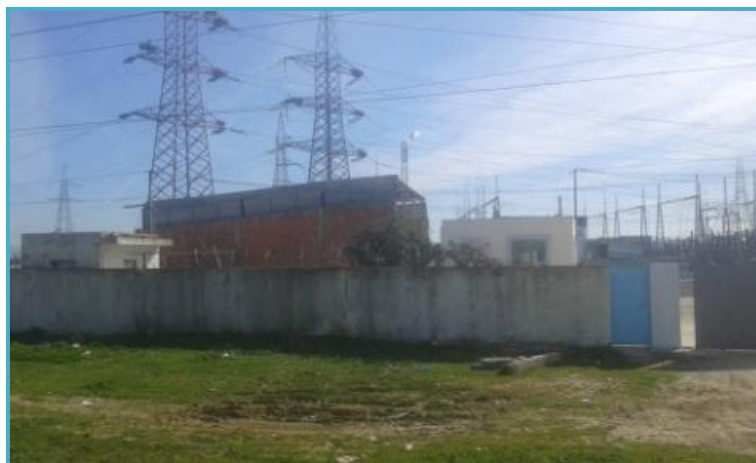
Figure 142 : Poste de Jendouba.
