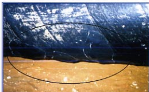
Défaut de revêtement causant la corrosion de la conduite (El Borma - Gabès)
