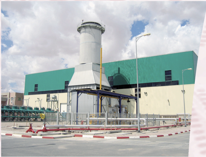
La centrale de Tyna mise en service en juin 2004
